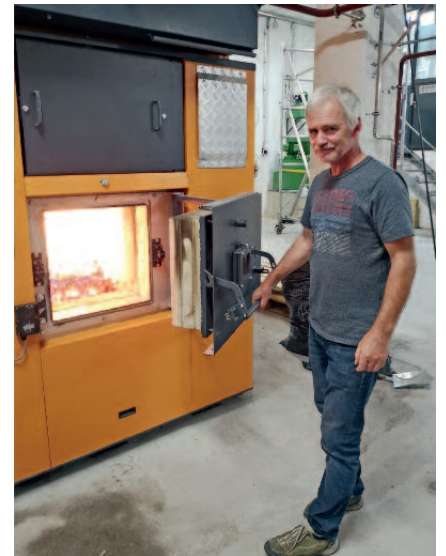
Werner Stocker Inbetriebnahme im September 2020
