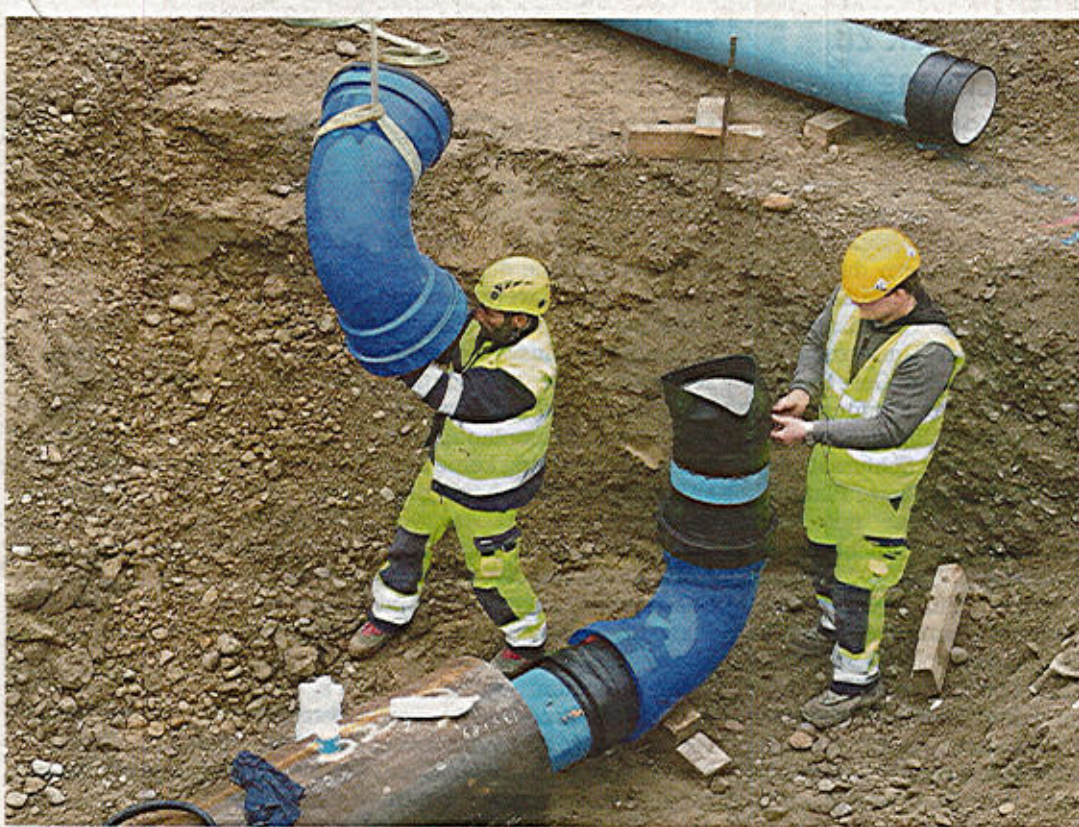
Wasserleitungen, die bald unter Verkehrskreisel der Tangente durchführen, wurden in sogenannte Futterrohre verlegt, damit sie im Schadenfall ersetzt werden können, ohne die Strasse aufbrechen zu müssen. Bild: Andreas Busslinger
